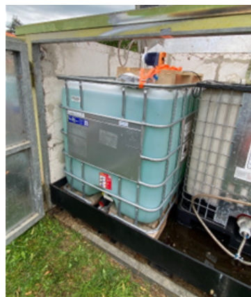
Dosierbehälter mit gebrauchsfertiger Lösung
