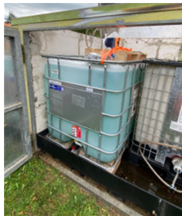
Réservoir de dosage avec la solution prête à l'emploi
