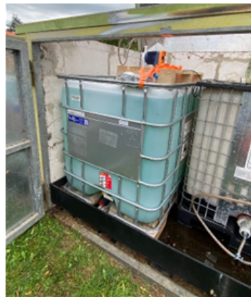
Serbatoio di dosaggio con la soluzione pronta all'uso
