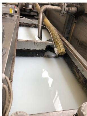
Foto 2 — Punto de inyección: un tubo fino fijado a la tubería existente lleva el producto directamente a la solución de polímero, dentro de la cuba.
