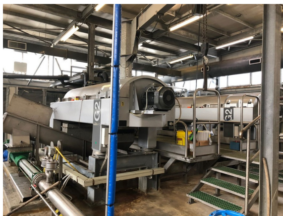
Foto 3 — Sala de deshidratación: centrífugas decantadoras y evacuación de la torta por tornillo. El producto llega aquí con el polímero, sin ninguna modificación de la línea.
