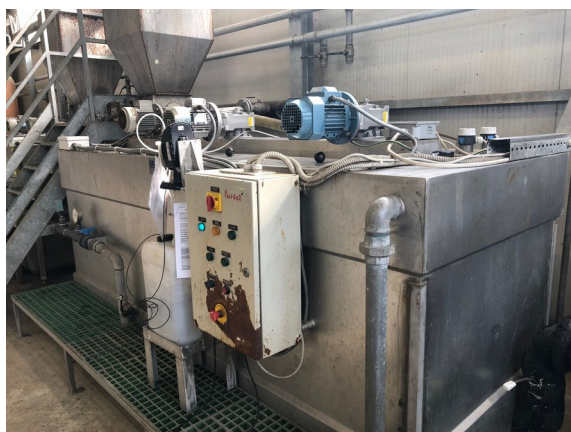
Foto 1 — Puesto de preparación del polímero. La bomba dosificadora y el bidón de producto están simplemente colocados al pie del preparador, junto al armario de control.
