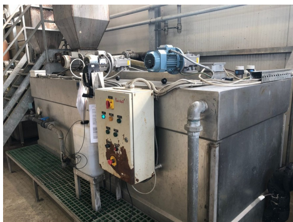
Foto 1 — Stazione di preparazione del polimero. La pompa dosatrice e la tanica di prodotto sono semplicemente collocate ai piedi del preparatore, accanto al quadro di comando.
