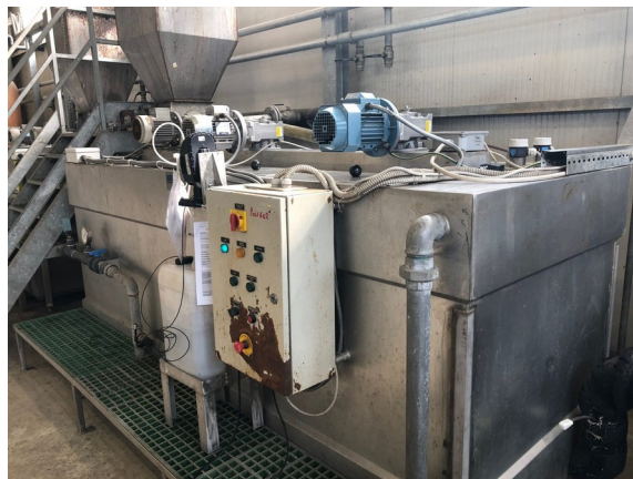
Foto 1 — Polymeransetzstation. Die Dosierpumpe und der Produktkanister stehen einfach neben der Station, beim Schaltschrank.
