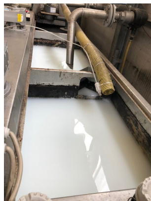
Foto 2 — Injectiepunt: een dun buisje, bevestigd op de bestaande leiding, brengt het product rechtstreeks in de polymeeroplossing, in de bak.
