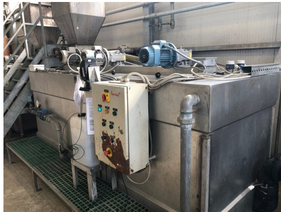
Foto 1 — Aanmaakinstallatie voor polymeer. De doseerpomp en de bidon met product staan gewoon aan de voet van de installatie, naast de styrkast.
