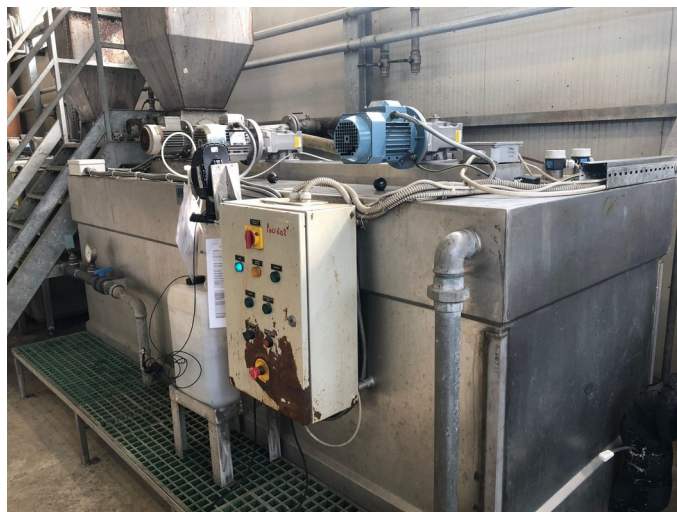
Foto 1 — Polymeransetzstation. Dosierpumpe und Produktkanister stehen einfach neben der Ansetzstation, beim Schaltschrank.
