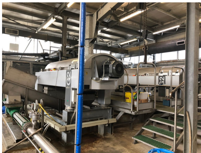
Foto 3 — Entwässerungshalle: Dekanterzentrifugen und Austrag des Schlammkuchens per Förderschnecke. Das Produkt gelangt hier mit dem Polymer hin, ohne jede Änderung an der Linie.
