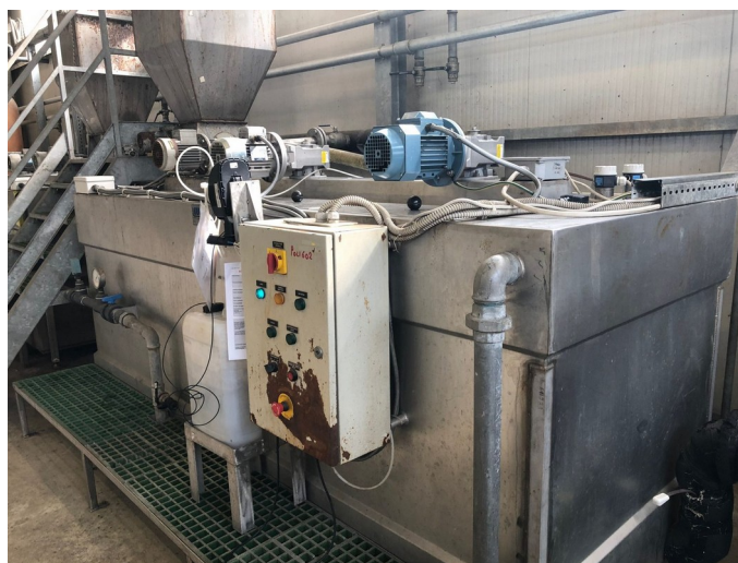
Foto 1 — Equipo de preparación del polímero. La bomba dosificadora y el bidón de producto están simplemente colocados al pie del preparador, junto al cuadro de mando.
