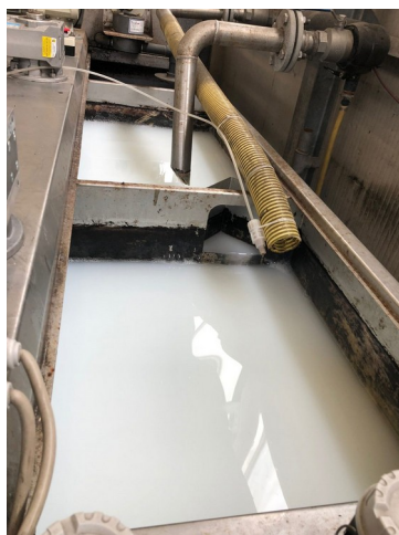
Photo 2 — Point d'injection : un tube fin fixé sur la canalisation existante amène le produit directement dans la solution de polymère, à l'intérieur du bac.
