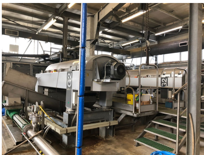
Foto 3 — Locale disidratazione: centrifughe decanter e ripresa del fango disidratato tramite coclea. Il prodotto arriva qui con il polimero, senza alcuna modifica della linea.
