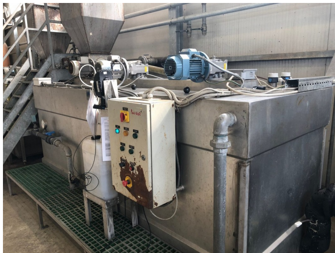
Foto 1 — Stazione di preparazione del polimero. La pompa dosatrice e la tanica di prodotto sono semplicemente collocate ai piedi del preparatore, accanto al quadro di comando.
